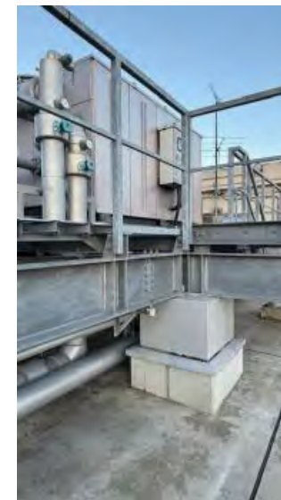
既存の柱を活用した屋上の設備架台
