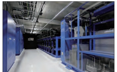
写真6 建屋内に実装したHydro Q-BiCo®
